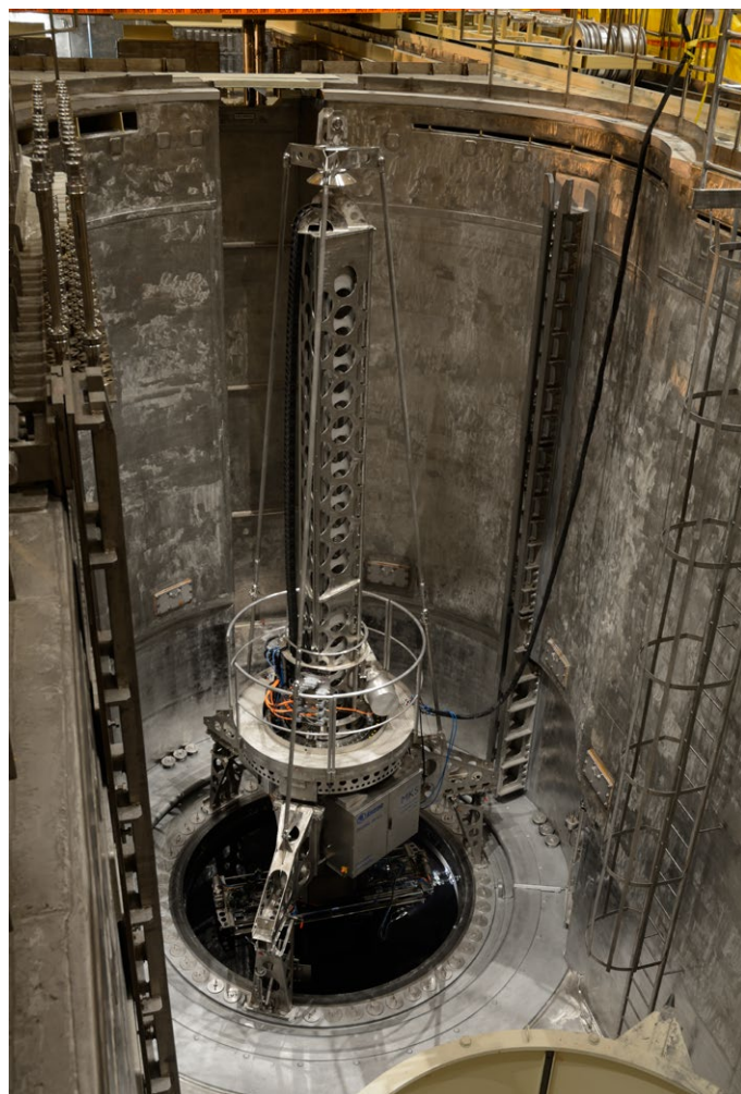
Modulární kontrolní systém (MKS) na JE Temelín |
