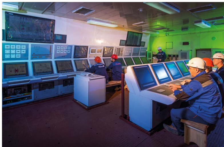
| Velín plovoucí jaderné elektrárny |
